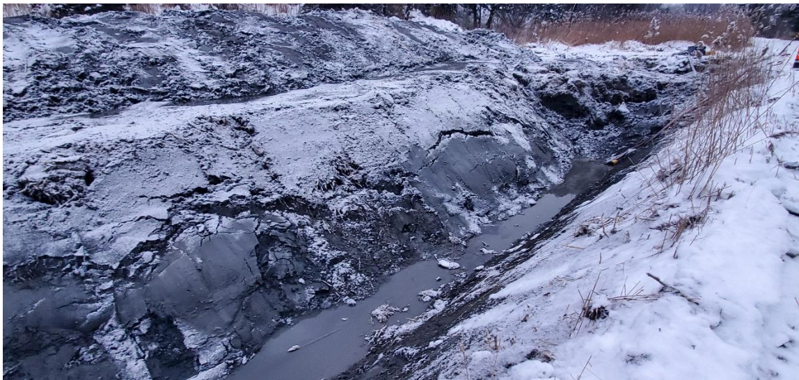
Figure 10. Instabilité du sol à la sortie, près du ponceau, en aval
