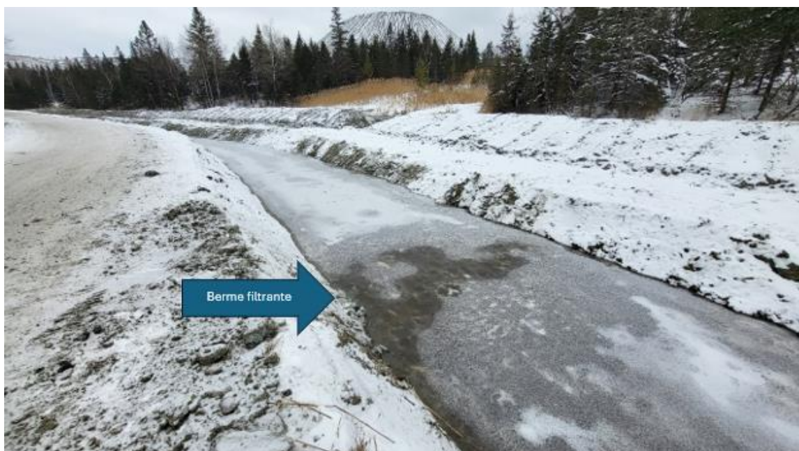
Figure 22. 2 e berme filtrante en fonction
